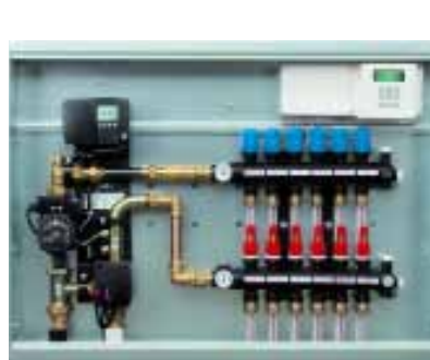
6. Heizkreisverteiler mit aufgelegten Heizleitungen.
