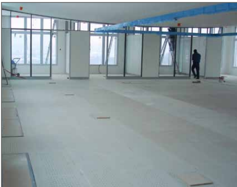
MERO Hohlboden Combi T im Barmenia Bürogebäude
