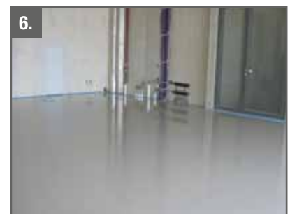
6. Nach dem Funktions- und Belegereifheizen ist der Mero Combi A Thermo bereit für die gewerksüblichen Vorbereitungen des Oberbelages.
