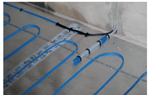
detail umístění instalační trubky pro podlahové čidlo
